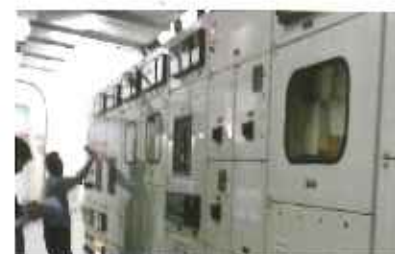
供電及照明系統
